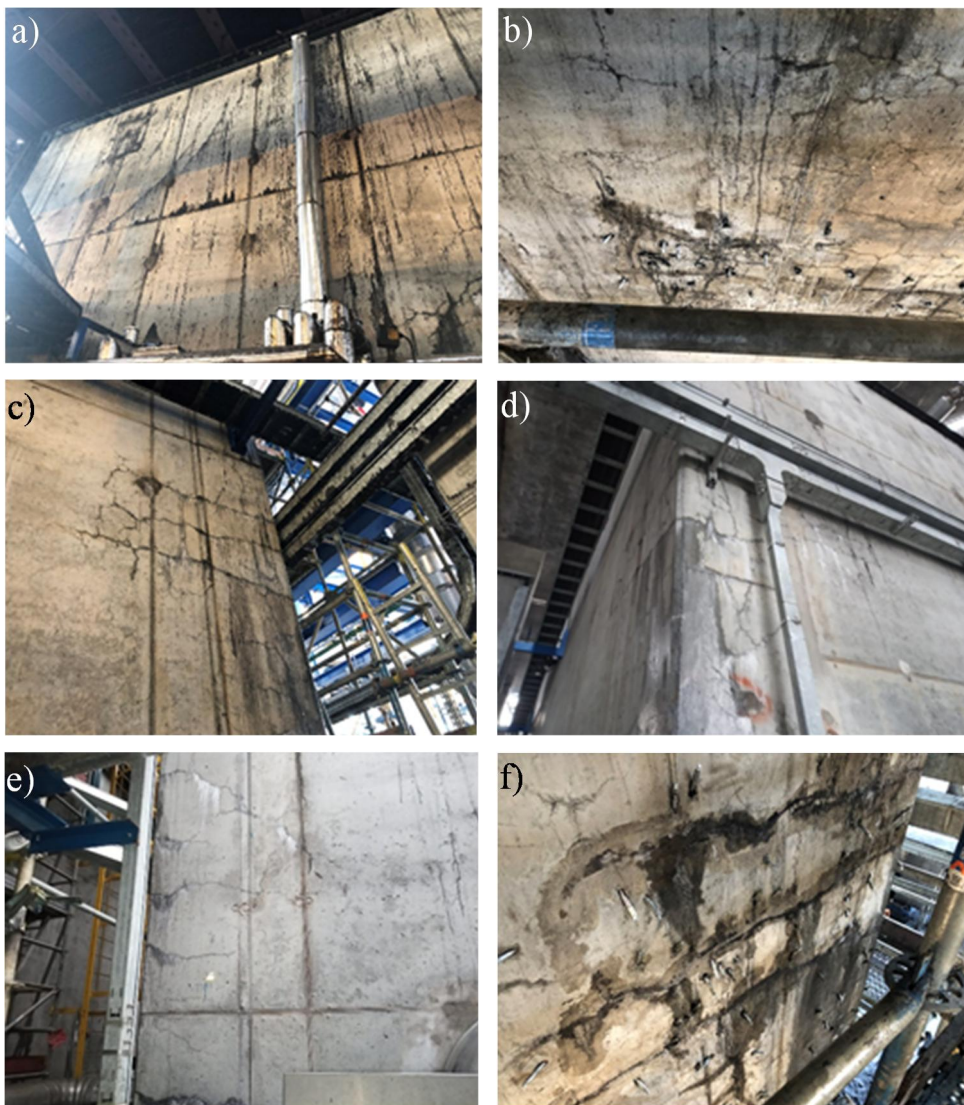
Rys. 2. Zbiornik X1 – rysy i pęknięcia: a), b) na ścianie wschodniej (B), c), d) w narożniku północno-wschodnim (C/B), e), f) w narożniku południowo-wschodnim (A/B).
